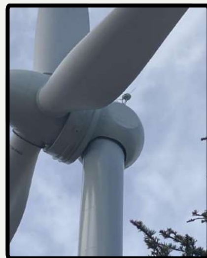
Photographie d'une éolienne prise sur le site
